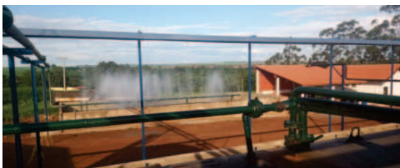
Resfriamento de água do reator
